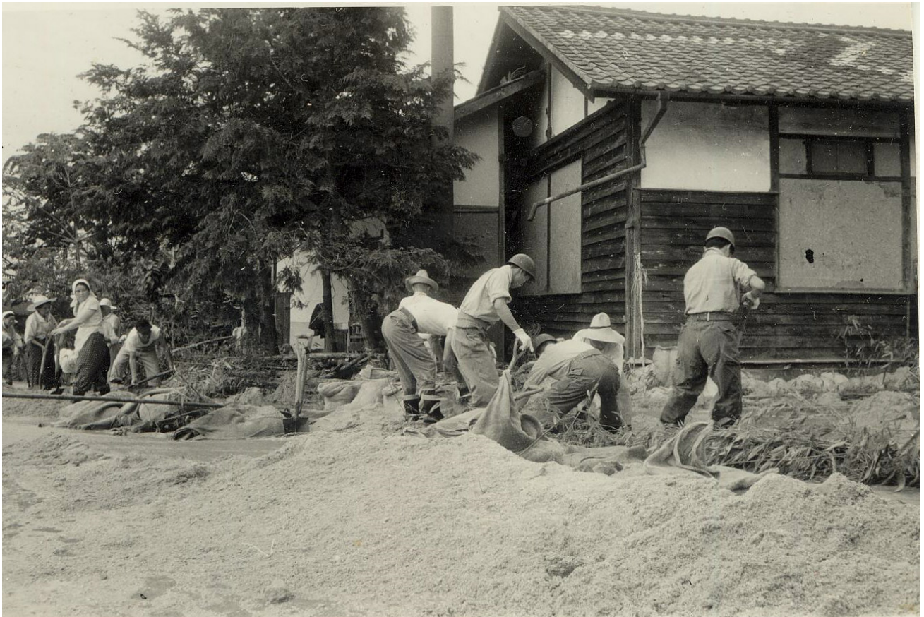
(No.5) 旧松洞川は自然の土手の底を流れていたが、鉄砲水の土砂で埋まり工場敷地に近くまで埋まった。掘り出し作業奉仕の皆さん。 写真は上流側から工場の東端を望む。中央にボイラー室と煙突が見える。
